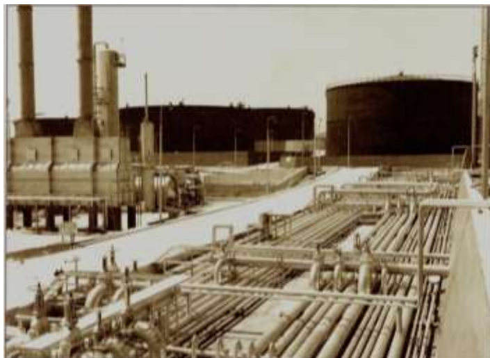
Οι σωληνώσεις του διυλιστηρίου της Πετρόλα Ελλάς
